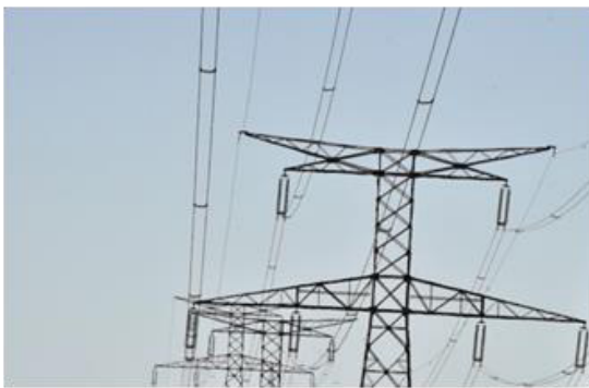
Distribution électriques en triphasée
