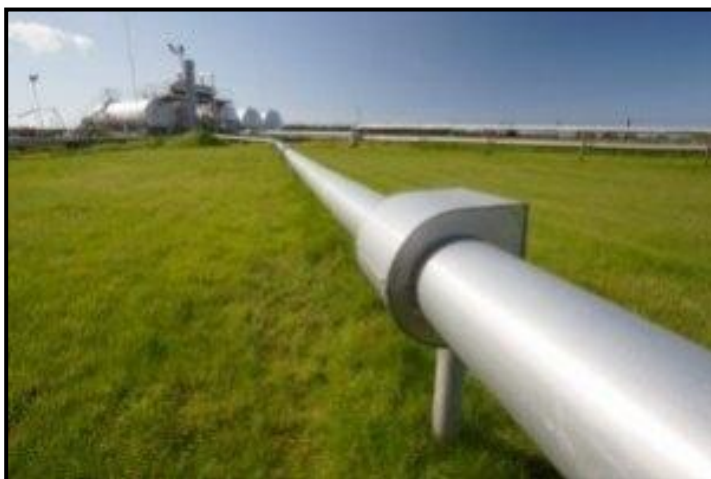
Figure 4.37: raccordement au réseau de distribution de gaz naturel
