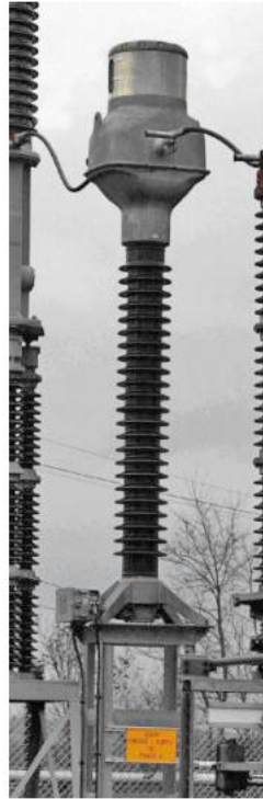
Fig. 25 : Transformateur de courant
