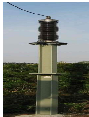
Figure III-3: Parafoudre à varistance sur ligne de transmission 110 kV
