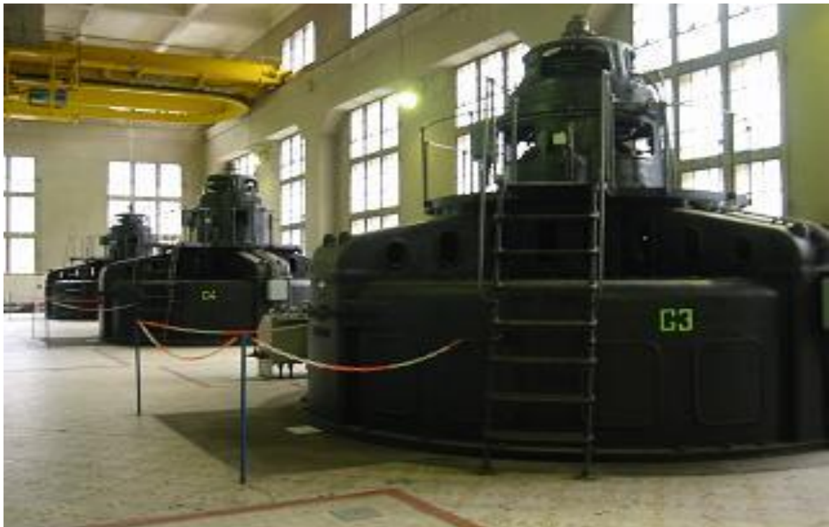
Fig. 9. Alternateurs d'une station électrique.
