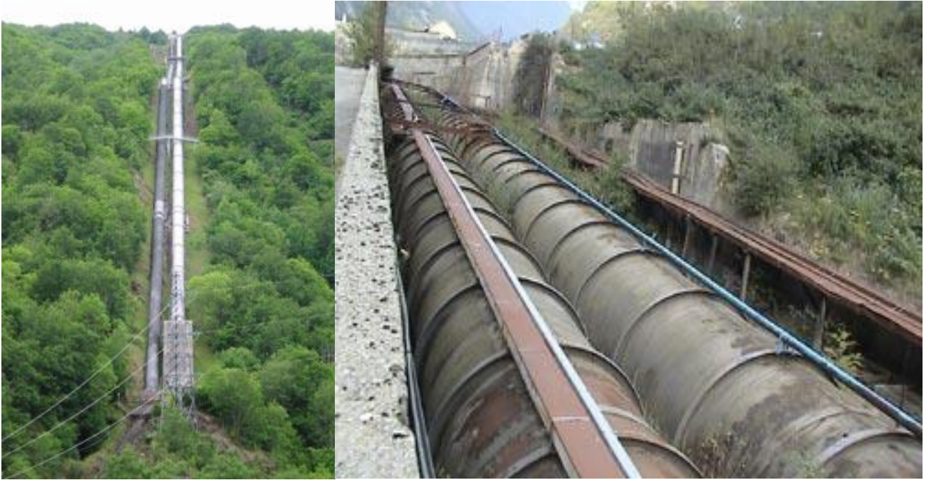
Fig. 8. Conduites forcées ou galerie d'amenée.
