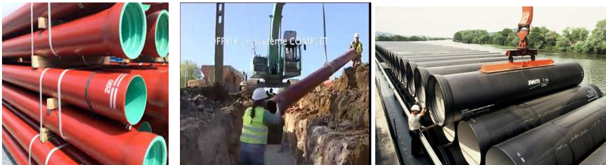
Figure 3 : Conduites en fonte ductile.
