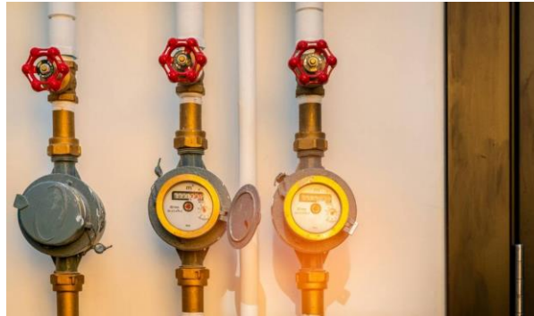
FigV.9 : Compteur d'eau divisionnaire.
