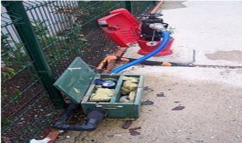
FigV.8 : Compteur provisoire raccordé à une borne d'incendie pour alimenter un chantier de construction.
