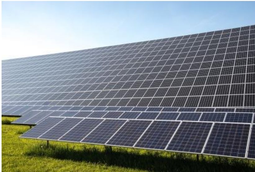
Champ de capteurs photovoltaïques.
