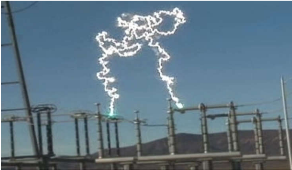
Figure (3): Arc électrique dans l'installation de hot tentions
