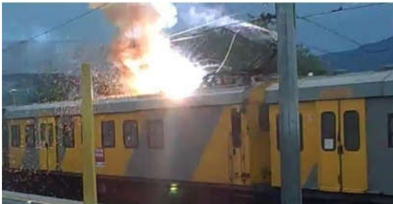
Figure (10): Explosion d'origine électrique
