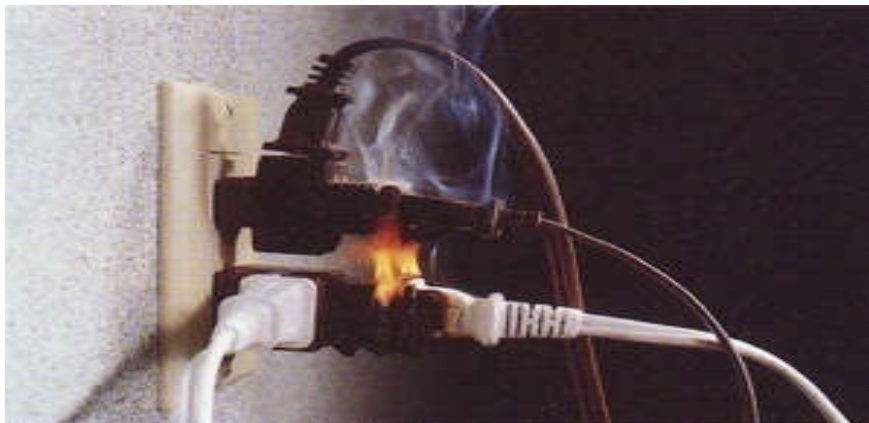
Figure (4): représentation d'un incendie causé par une surcharge électrique
