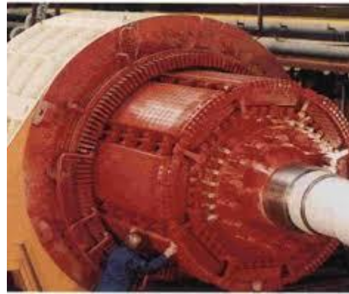
Turbo ALT d'une centrale électrique
