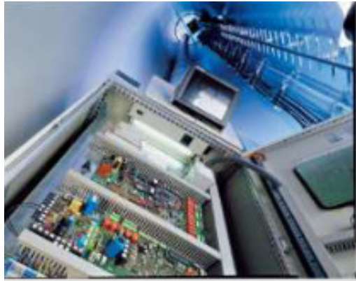
Figure 20 Contrôleur d'une éolienne
